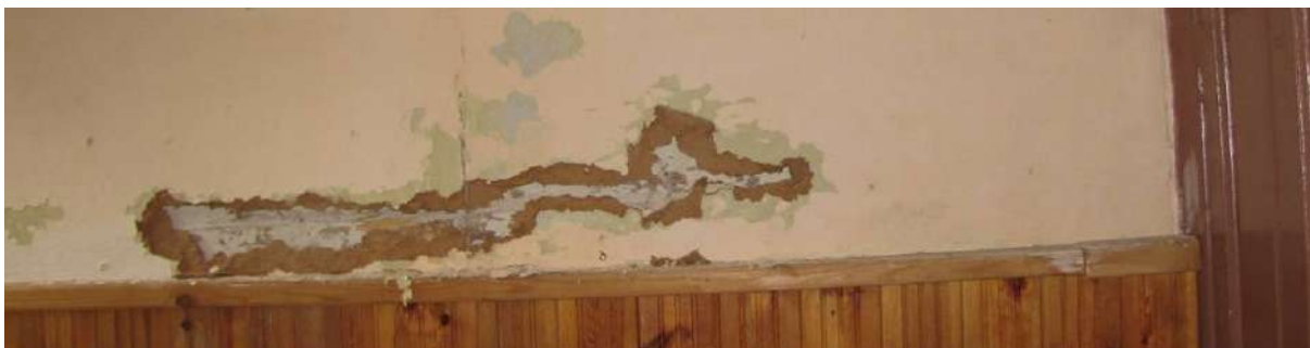
Fot. 11 Odkrywka na ścianie w przedsionku oddzielającej go od pomieszczenie narożnego, uwidaczniająca bielone, ciągle bale sosnowe.
