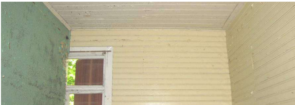
Fot. 20 Fragment skrajnego pokoiku we wschodnim narożniku budynku uwidaczniająca zróżnicowanie materiałowe wykończenia ścian. Zewnętrzne są oszalowane, działową (dzielącą również na połowę okno), wykonano z płyty wiórowej.
