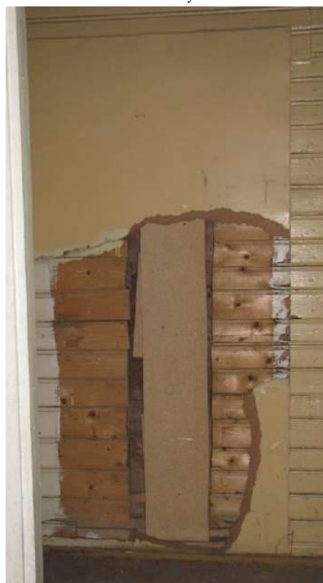
Fot . 7 Anomalie w oszalowaniu ściany w korytarzu wschodnim
