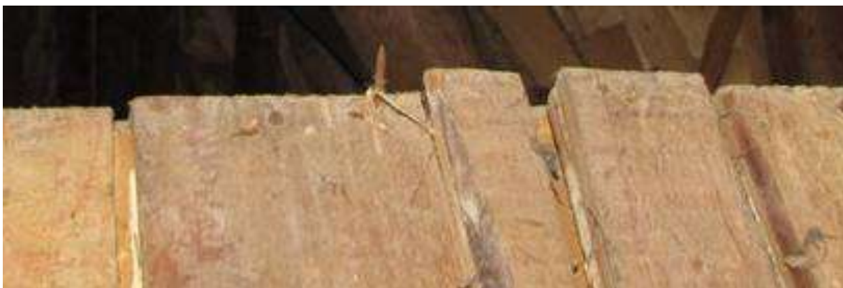
Fot. 35 Detal fragmentu ścianki działowej poddasza widoczny od strony przestrzeni nieużytkowej.
