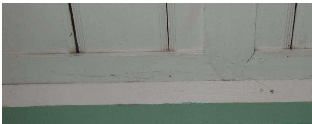
Fot. 30 Fragment sufitu w ostatnim pokoju we wschodnim narożniku budynku.
