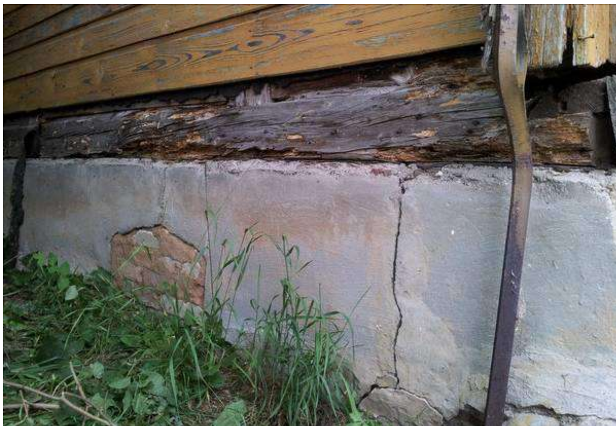
Fot. 41 Fragment fundamentu i podwaliny ściany frontowej wschodniego ryzalitu, przy południowym narożniku budynku. Widoczne również: zarysowania fundamentów i zamurowanie okna piwnicy gospodarczej.
