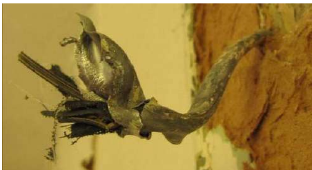
Fot. 45 Aluminiowy przewód elektr. w ołowianej osłonie na ścianie dawnej kuchni.
