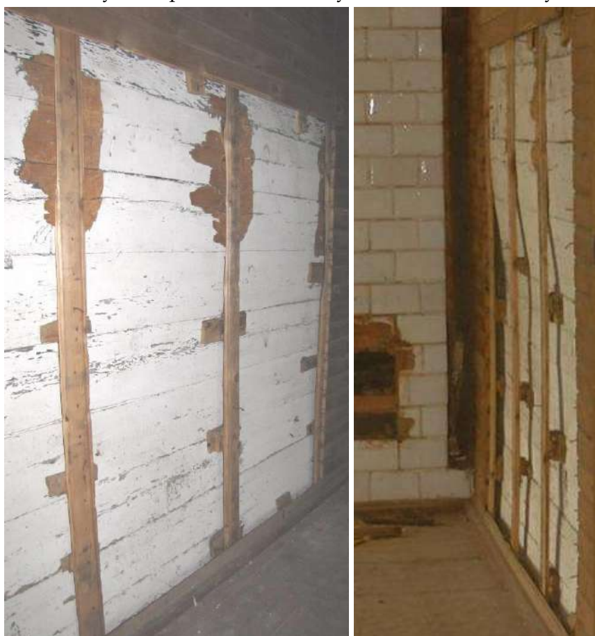
Fot. 5. i 6 Odkrywka na podłużnej ścianie wieńcowej wewnętrznej w dawnej stołówce, uwidaczniająca wypaczenia belek, wymagających podcięć i podkładek przy wyrównywaniu ściany deskami szalunkowymi.
