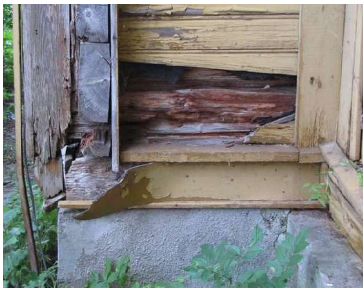
Fot. 43 Południowy narożnik podwaliny zachodniego ryzalitu.
