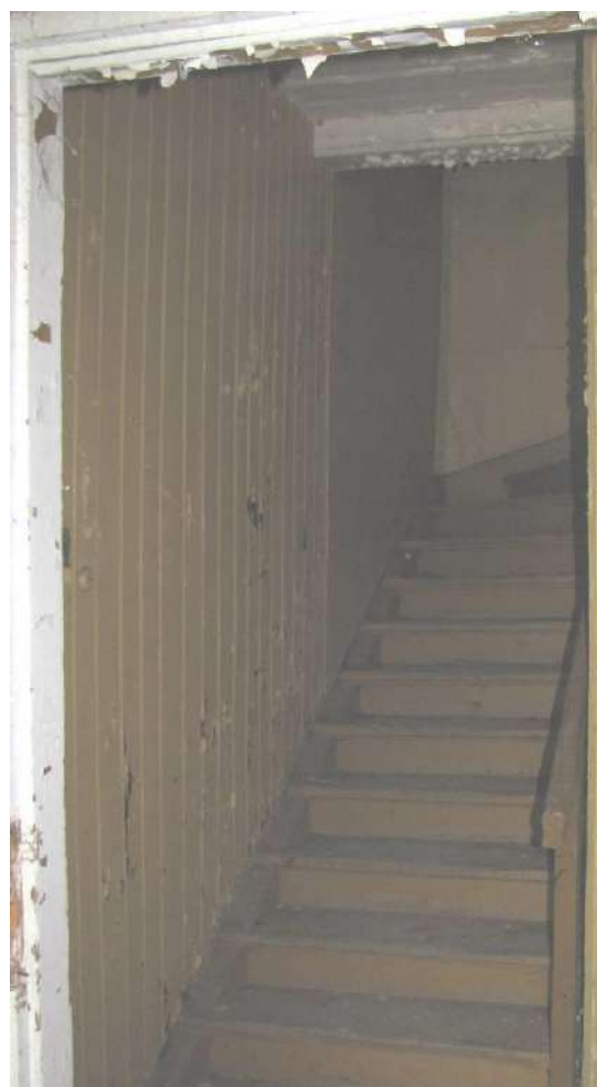
Fot. 37 Ściana klatki schodowej oszalowana odmiennie od pozostałych w parterze,
