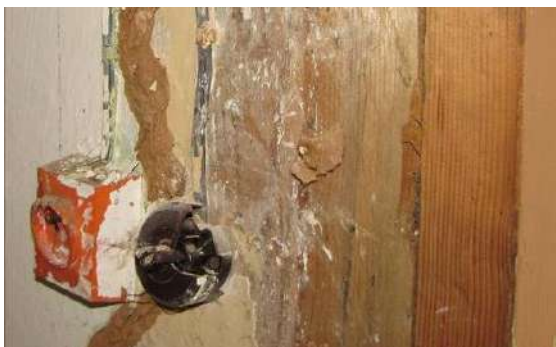
Fot. 44 Przełącznik oświetlenia dawnej instalacji elektrycznej na ścianie dawnej kuchni.
